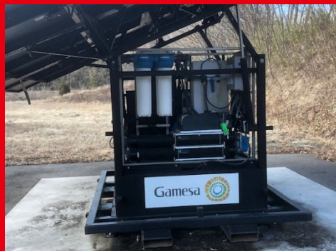
太陽光発電で稼働する浄水機器
